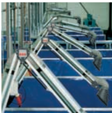
Absaugarme in einer Schweißerei
