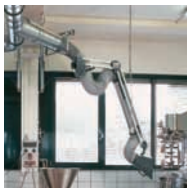
Absaugarm mit Ausleger in einem chemischen Betrieb
