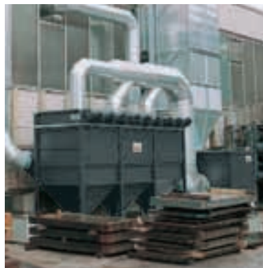
DUSTEX S als Aussenanlage mit drei Modulen
